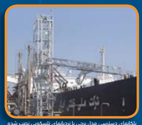
پلکانهای دسترسی مدل برچی با نردبانهای تلسکوپی نصب شده بر روی تانکرها بسته شده به اسکله شماره 0 - جزیره خارک ایران، همچنین پلکانهای مدل برچی مشابهی به اسکلهای شماره ۶، ۷، ۱۱، ۱۲ و ۱۳ تحویل داده شده است.
